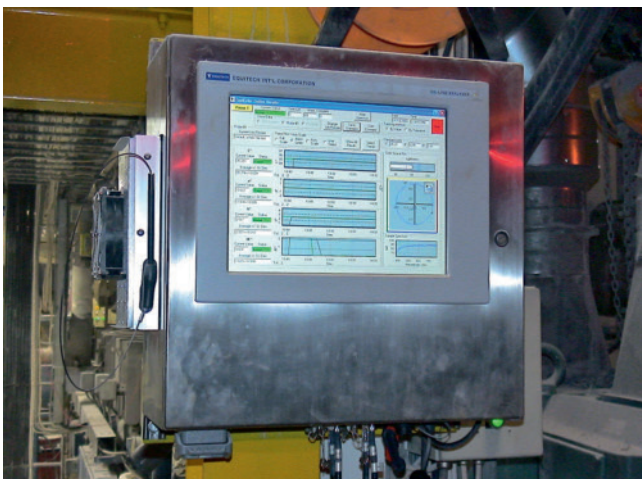
Bild 3. Die Nema 4 Box mit Touchscreen beinhaltet die gesamte Messtechnik
